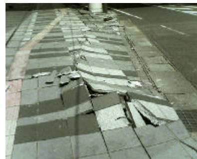
地震で激打ってしまった 歩道ブロック
